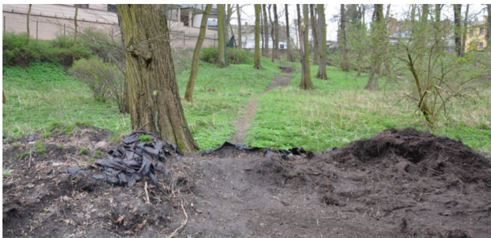
Ryc. 68: ulegająca erozji skarpa w lokalizacji siedzisk amfiteatru / fotografia ACAKA 2022
