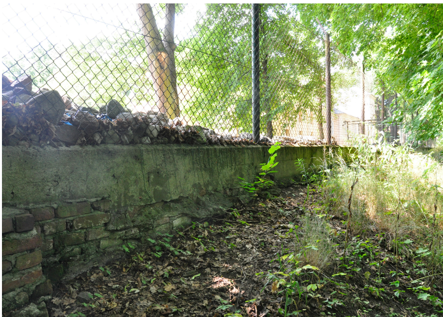
Ryc. 4: stan techniczny ogrodzenia na krawędzi skarpy / fotografia ACAKA 2022
