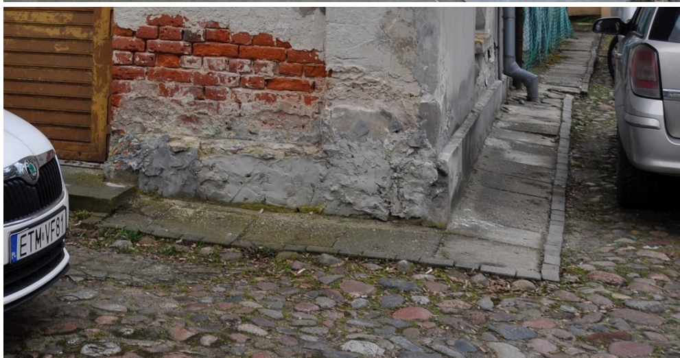
Ryc. 95: bruk kamienny przy narożniku budynku dawnej wozowni – widoczne zawilgocenie ścian oraz zniszczona opaska z płyty betonowej przewidziana do wymiany na opaskę z płyty kamiennej / stan 2023
