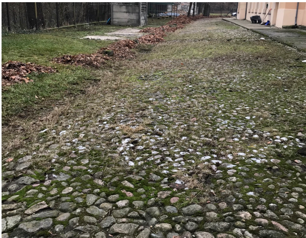
Ryc. 92: Widoczny znacznie uszkodzony bruk kamienny od strony północnej, od strony parku – w miejscu projektowanego tarasu z płyt kamiennych / stan 2023, fotografia ACAKA
