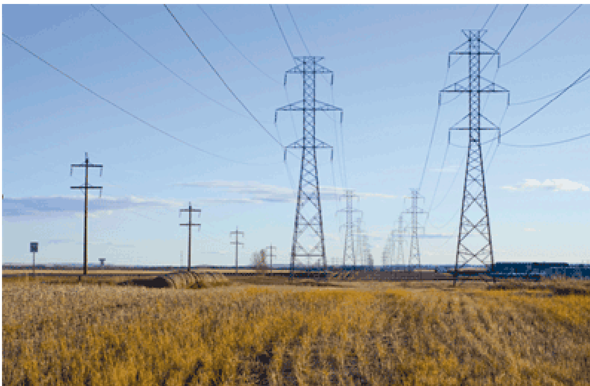
Fot. 5.1 Linie wysokiego napięcia, źródło: www.energoelektronika.pl
