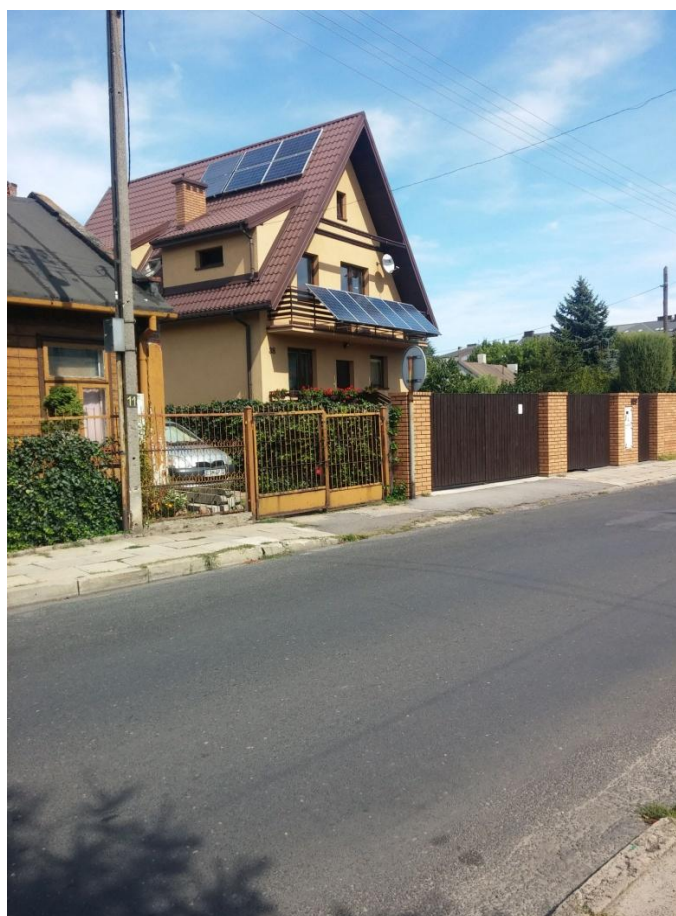
Fot. 3-3 Ogniwa fotowoltaiczne na ulicy Smugowej
